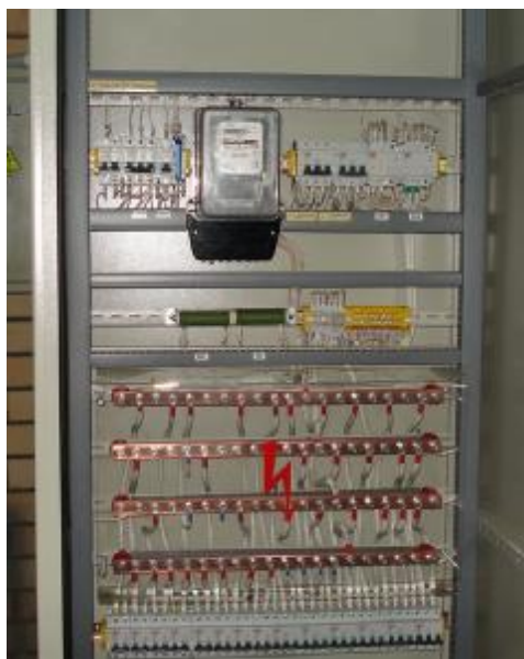
Рис. 1. Общий вид панели (дверь открыта).
