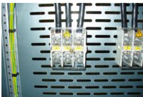
Рис. 4. Отсек кабельных присоединений.
