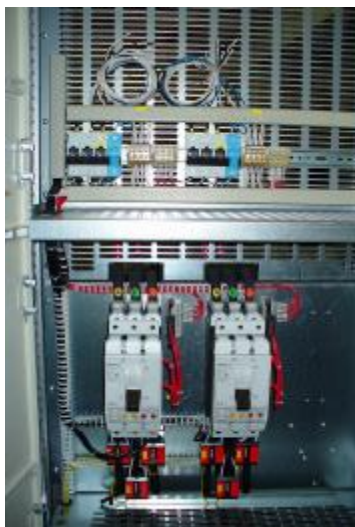
Рис. 2. Отсек с автоматическими выключателями.
