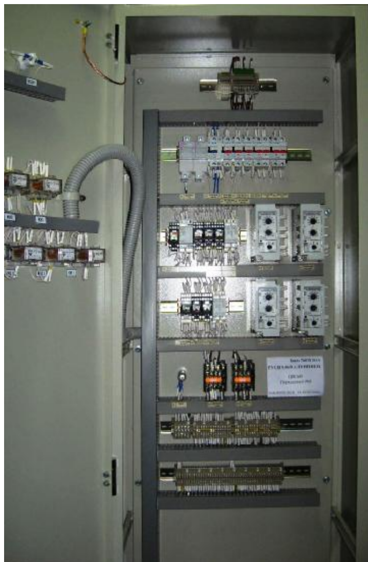
Рис. 10 Шкаф общесекционных нужд
