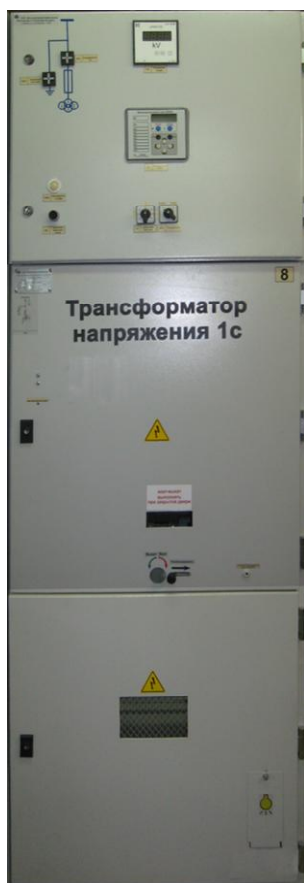
Рис. 14. Внешний вид шкафа ТН.
