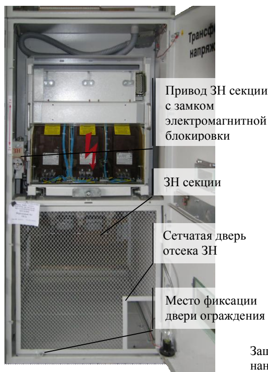
Рис. 15. Отсеки ВЭ и ЗН шкафа ТН.
