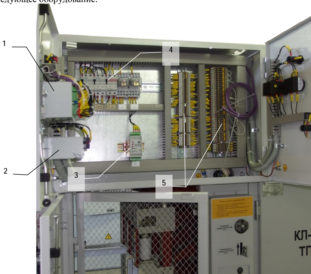
Рис. 13 Оборудование релейного отсека камеры.
