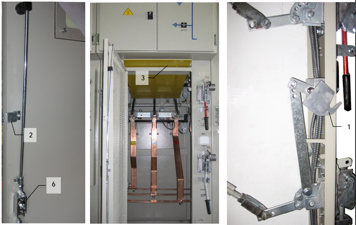
Рис. 5 Камера секционного разъединителя.
