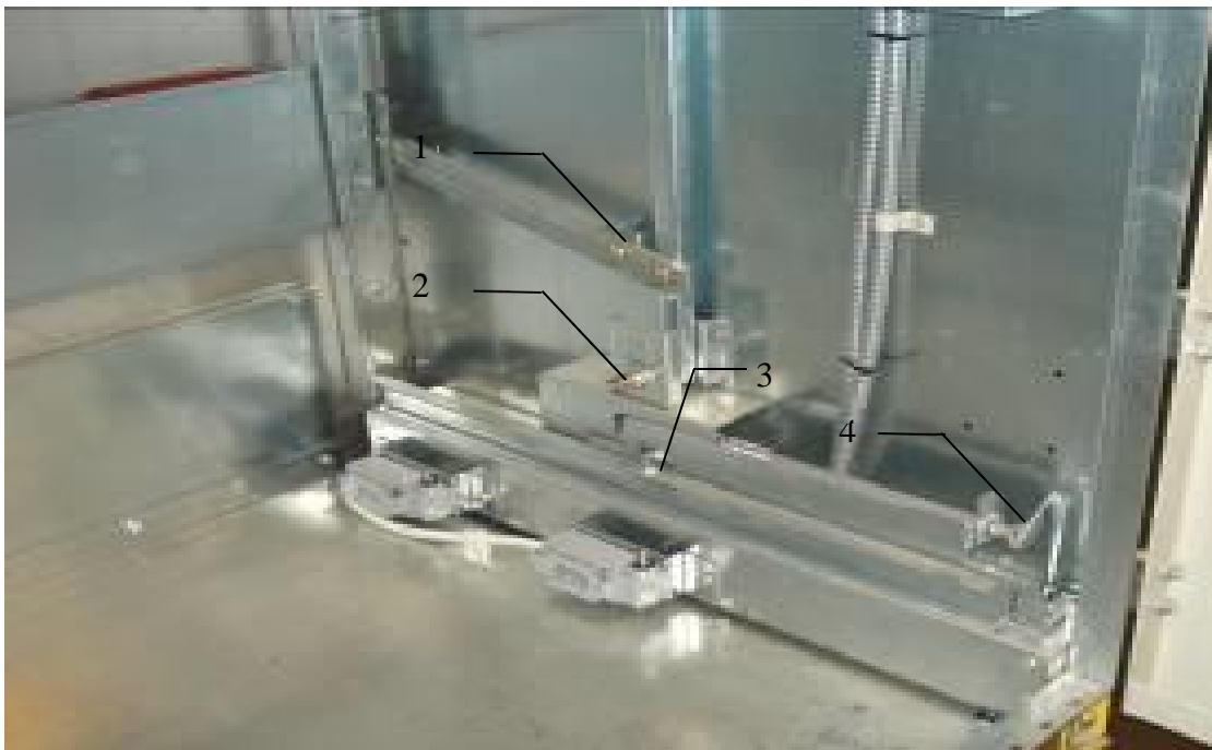
Рис. 7. Правая сторона отсека ВЭ, блокировки.
