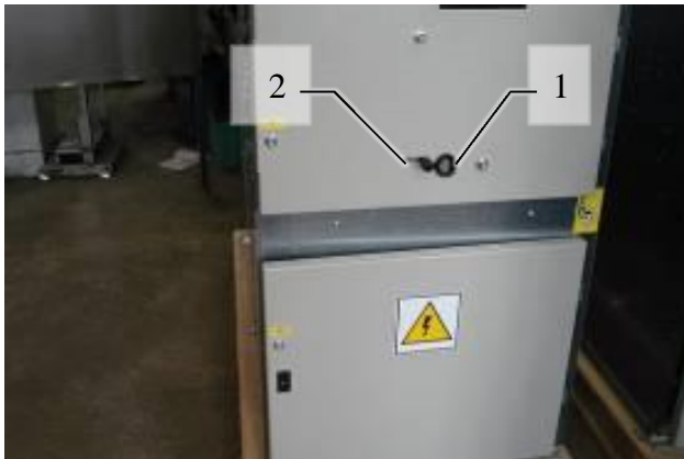
Рис. 3. Дверь отсека ВЭ.
